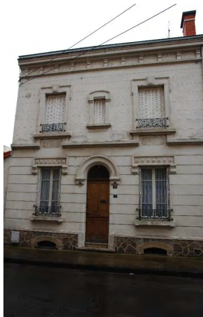
Exemple d'une maison ne pouvant pas supporter la mise en place d'une ITE : on perdrait ici tout l'intérêt de la modénature.
