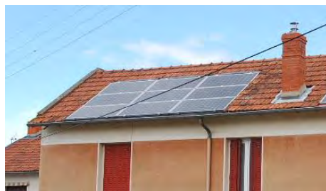
exemple de panneaux solaires photovoltaïques
