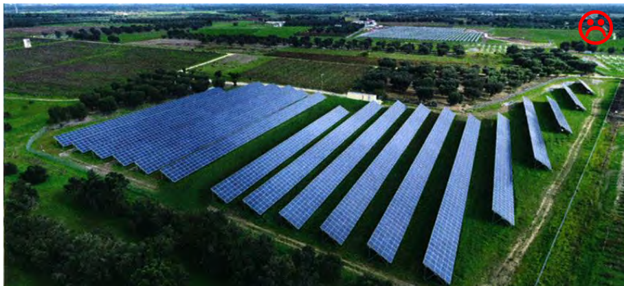
exemple d'un champ photovoltaïque dans la région de Puglia en Italie
