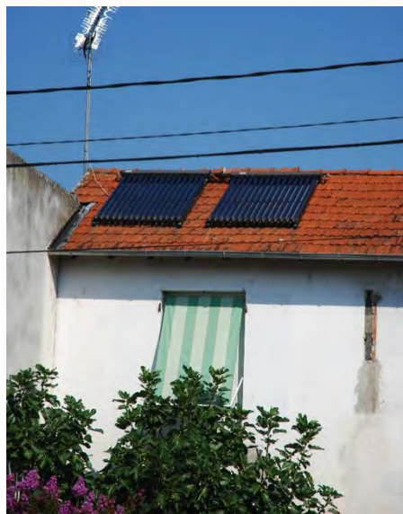
Panneaux solaires thermiques tubulaire permettant la production d'eau chaude sanitaire privée
