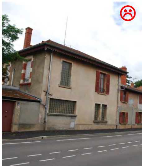
exemple d'une façade dans les percements ont été dénaturés
