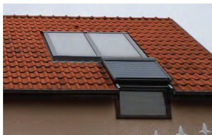
exemple de panneaux solaires thermiques
