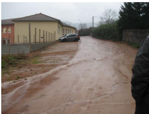
Fig. 32. Ruissellement des EP sur le chemin au nord de l'école – Saint-Alban-les-Eaux
